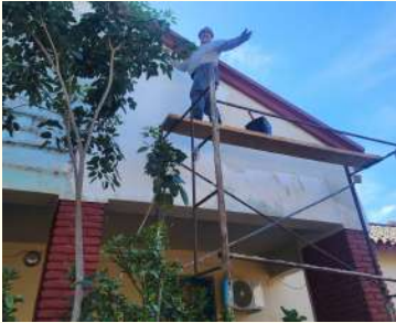
Trabajo en altura.
