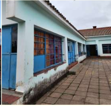
Deterioro propio de los años
